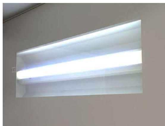
LED照明(側面取付)
