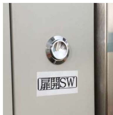
エアシャワー内扉開スイッチ (自動ドア仕様)
