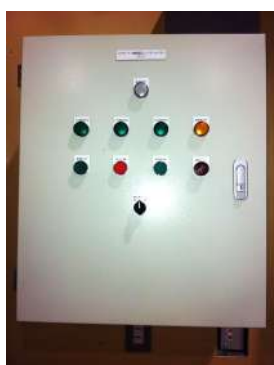
エアカーテン用制御盤
