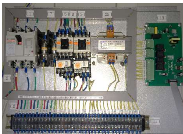
エアシャワー制御部
